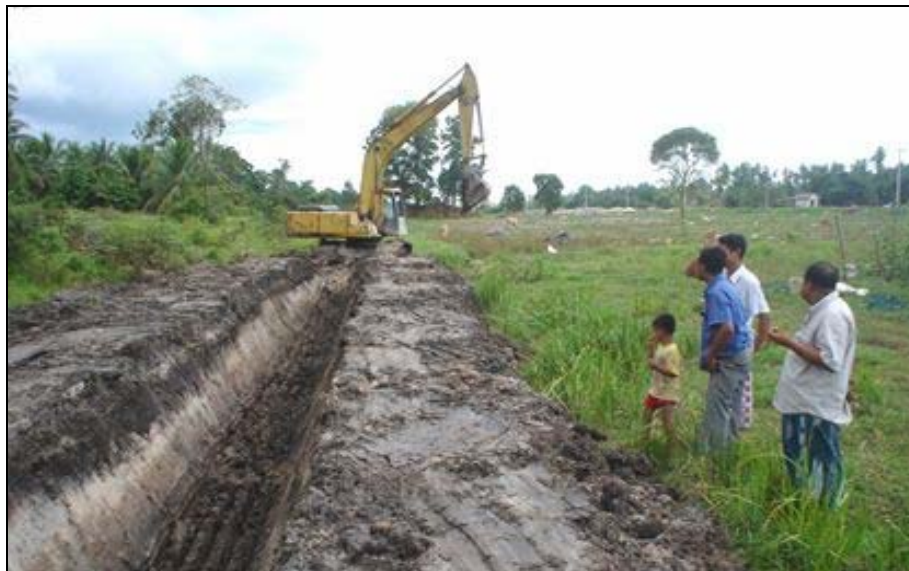
ชุดคลองระบายน้ำที่บ้านบาละ ตำบลปะเสยะวอ อำเภอสายบุรี
