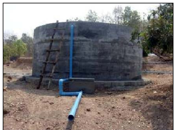
บ่อพักน้ำคอนกรีตเสริมเหล็ก
