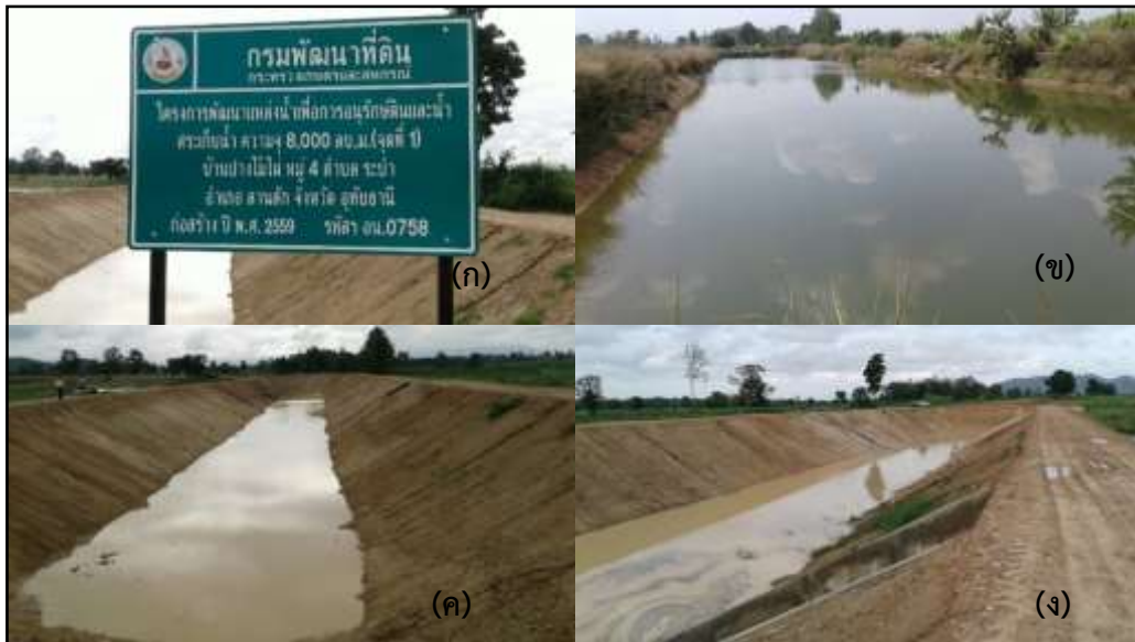
ภาพที่ 2 โครงการพัฒนาแหล่งน้ำเพื่อการอนุรักษ์ดินและน้ำ สระเก็บเก็บน้ำ ความจุ 8,000 ลูกบาศก์เมตร (จุดที่ 1) บ้านปางไม้ไผ่ หมู่ 4 ตำบลระบำ อำเภอลานสัก จังหวัดอุทัยธานี (ก,ข,ค,ง)
